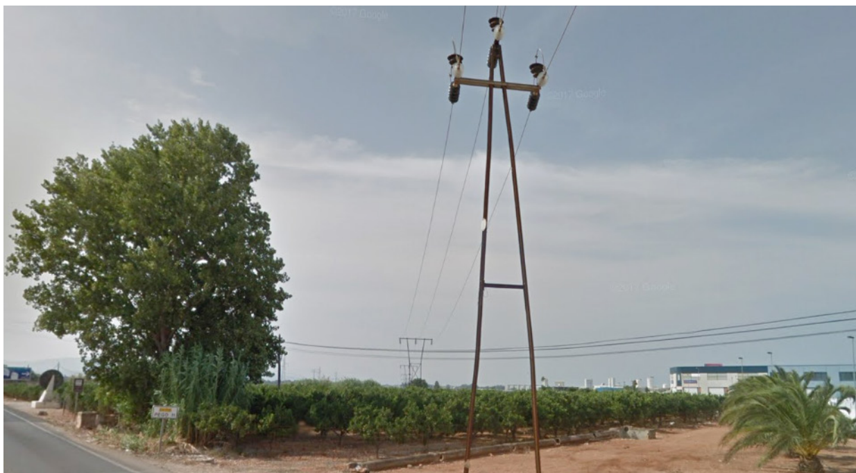
Suports de la línia elèctrica Gandia-Oliva-El Verger.
