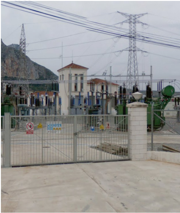
Sub-estació del Verger.
